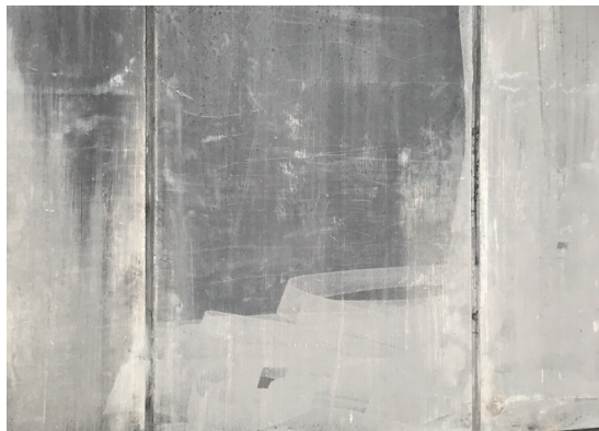
汚れが目立つ外壁
