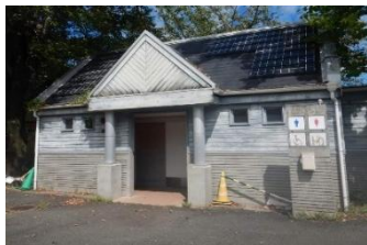
▲老朽化した施設（トイレ）
