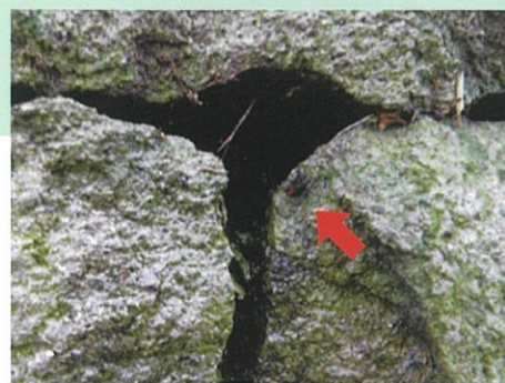
石積壁の 隙間
