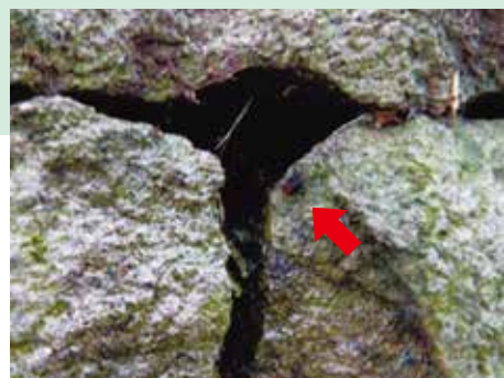
石積壁の 隙間
