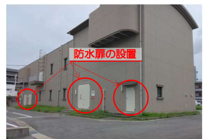
塩原送水ポンプ場の防水扉設置状況
