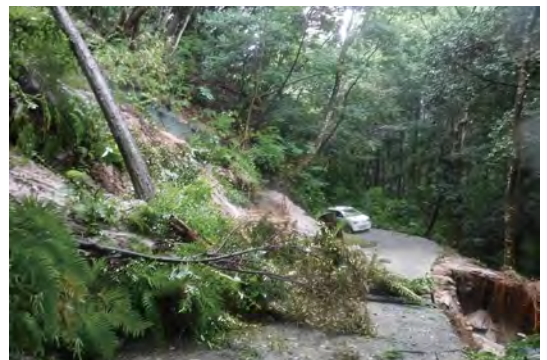
集中豪雨による林道の土砂災害
