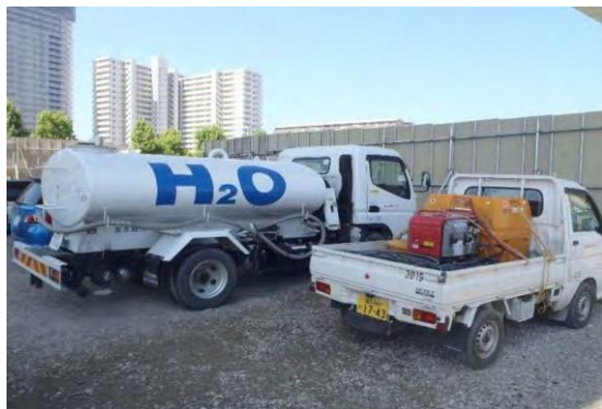
写真②-1 施工ヤードの散水設備
