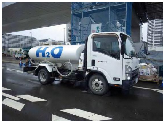
写真⑤-1 施工ヤードの散水設備
