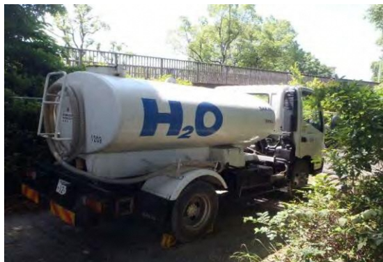
写真①-1 施工ヤードの散水設備
