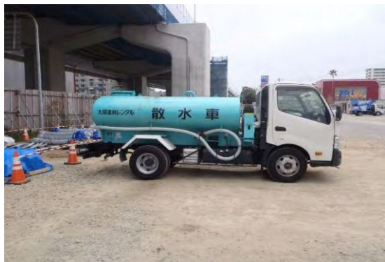
写真⑥-1 施工ヤードの散水設備
