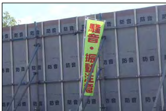
写真①-4 防音パネル等の遮音対策
