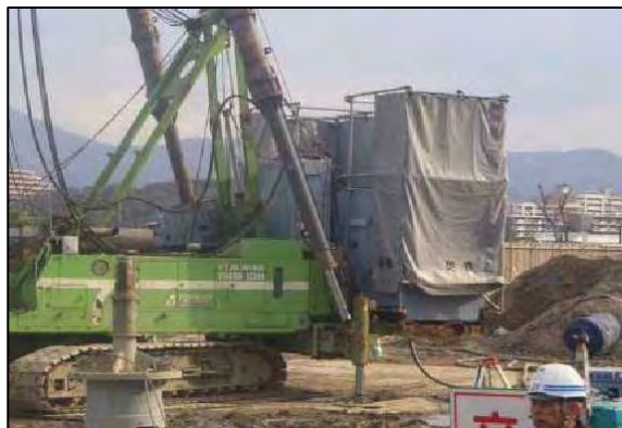
写真②-3 発電機の防音シート
