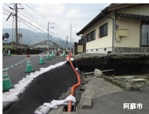
熊本地震断層沈下状況(平成 28 年 4 月)
