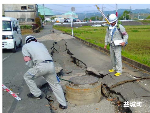
熊本地震管渠被災状況（平成 28 年 4 月）
