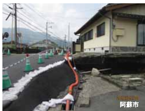
熊本地震断層沈下状況(平成 28 年 4 月)
