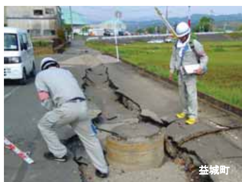
熊本地震管渠被災状況（平成 28 年 4 月）
