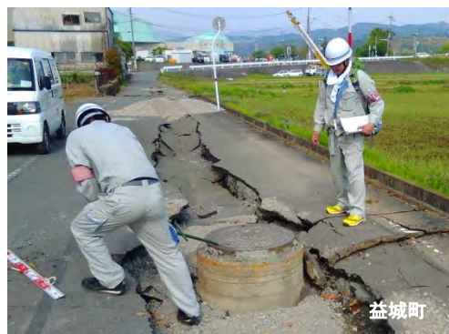
熊本地震管渠被災状況（平成 28(2016)年 4 月）
