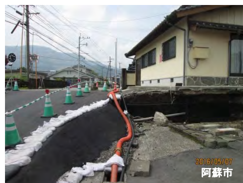
熊本地震断層隆起状況(平成 28(2016)年 4 月)
