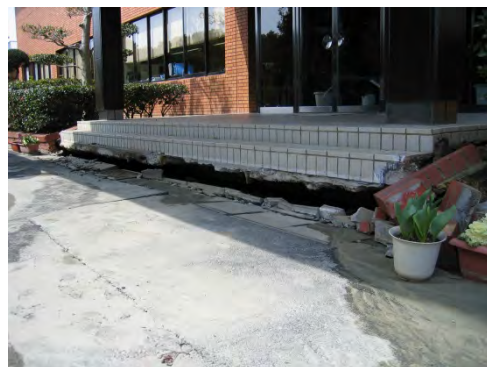
液状化により沈下した西戸崎水処理センター
