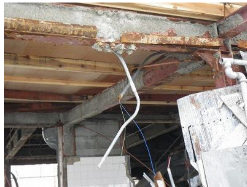
建物に残存した吹付け材
