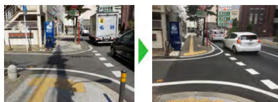
■歩道のバリアフリー化 (マウントアップの改善、誘導ブロック設置)
