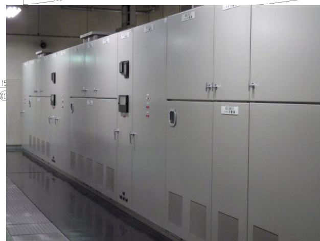
特別高圧受変電設備
