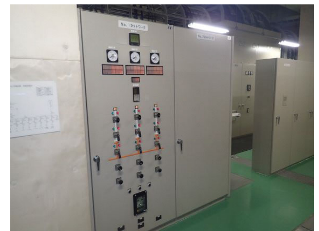
電力監視設備
