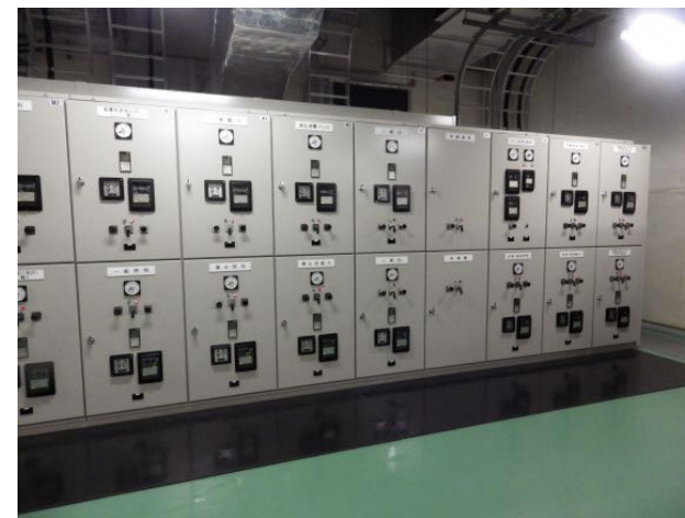
高圧配電設備
