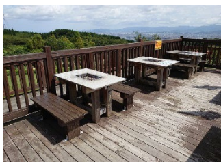
老朽化したバーベキューデッキ
