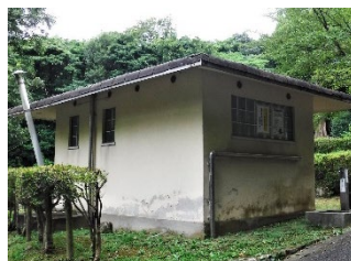
築45年が経過したトイレ
