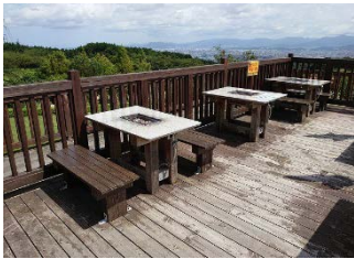
老朽化したバーベキューデッキ
