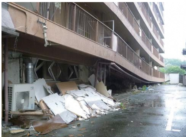
【写真：被害の様子】
