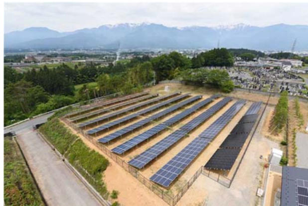
図表 56 リユース品を使用した発電所
