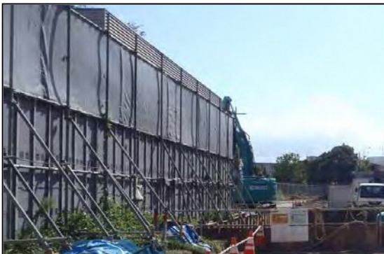
写真①-3 防音パネル等の遮音対策
