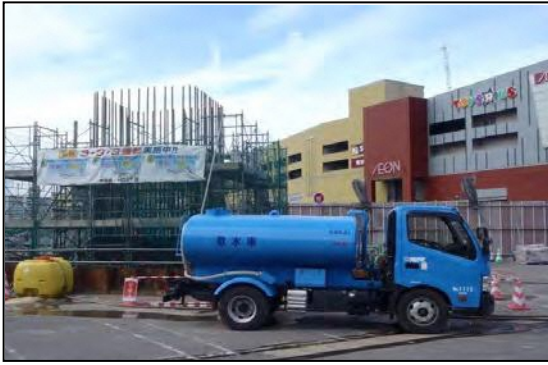
写真①-1 施工ヤードへの散水設備
