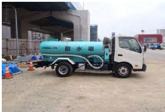
写真⑥-1 施工ヤードの散水設備
