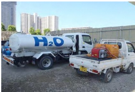
写真②-1 施工ヤードの散水設備
