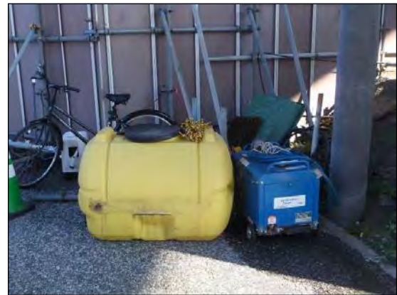
写真①-6 工事用車両のタイヤ洗浄設備
