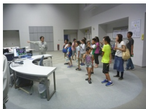
①中央制御室
