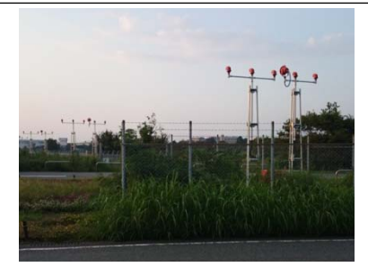
航空保安関係施設（進入灯）
