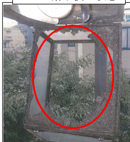
カバー落下後の状態
