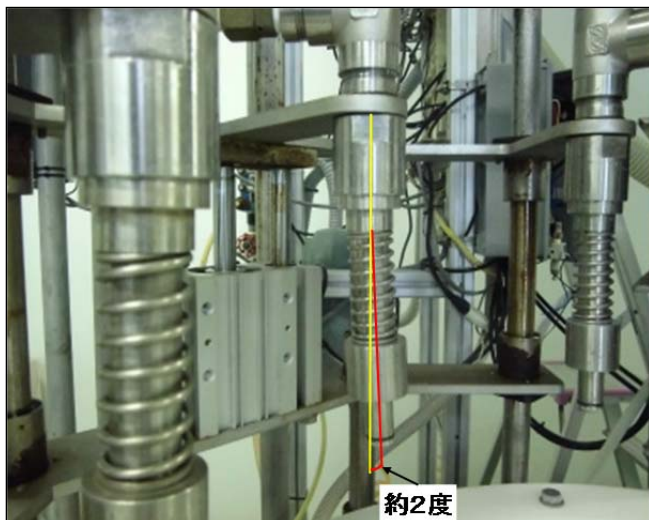
写真-4 曲りの確認された 充填機ノズルシリンダー
