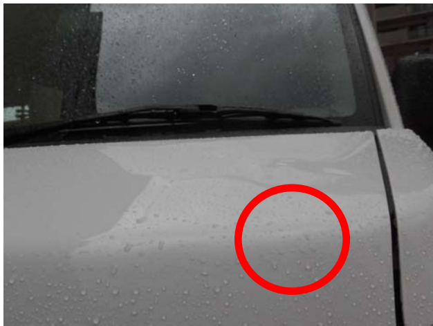
④破損状況
