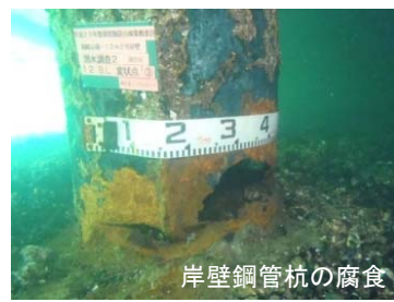
岸壁鋼管杭の腐食 老朽化する港湾施設
