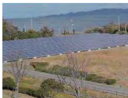
▲大原メガソーラー発電所
