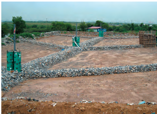
ハイフォン市ディンブー埋立場 福岡方式による改善状況(2011年)
