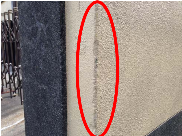
②破損状況
