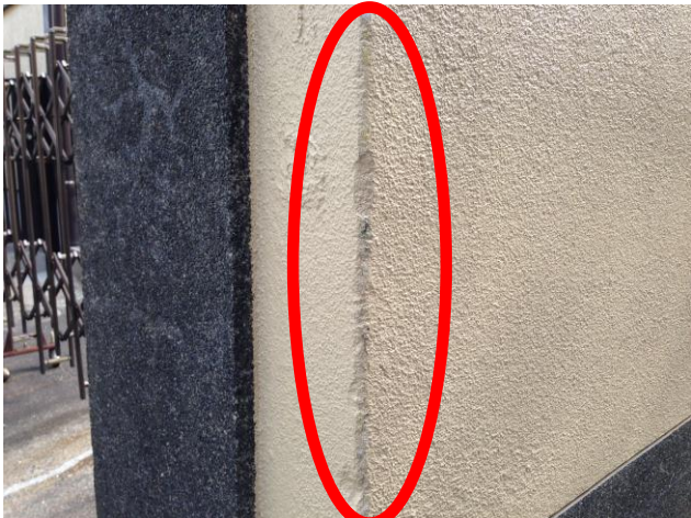
②破損状況
