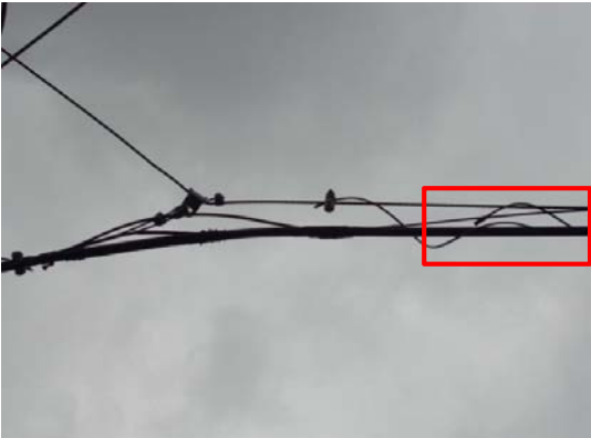
外れたワイヤーの留め具(吉岐小学校西側路上から撮影)
