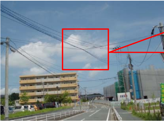
緩んだ電線(吉岐小学校西側路上から北方面を撮影)
