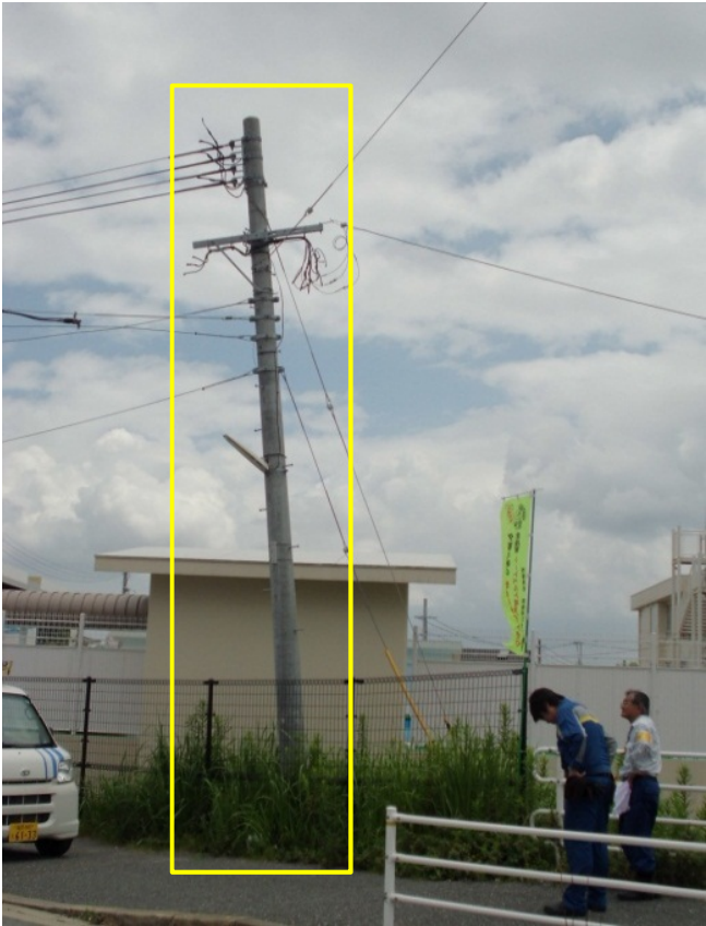
傾いた電柱(吉岐小学校西側路上から撮影)
