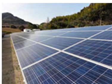
西部中田埋立場に設置した大原メガソーラー発電所
