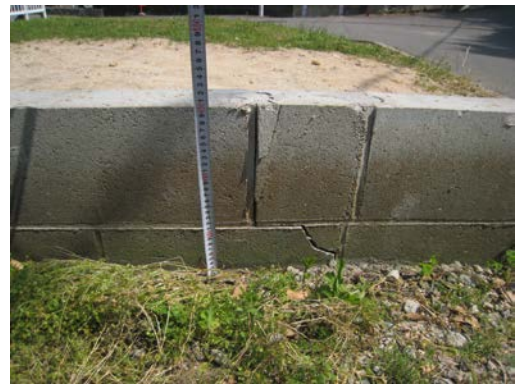
③ブロック破損状況
