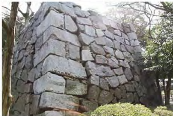
写真2-24:ずれと迫り出し(鉄物櫓跡)
