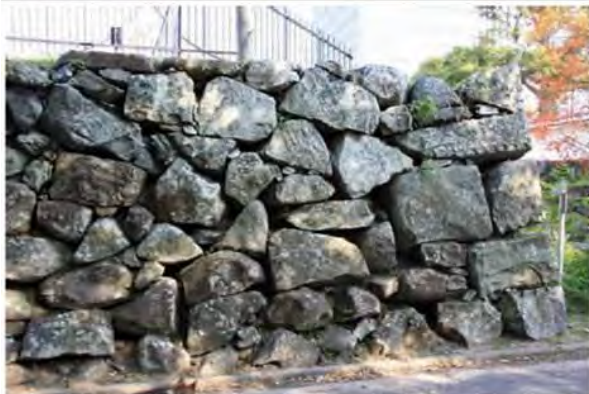
写真2-23:間詰め石の抜け(三ノ丸西)
