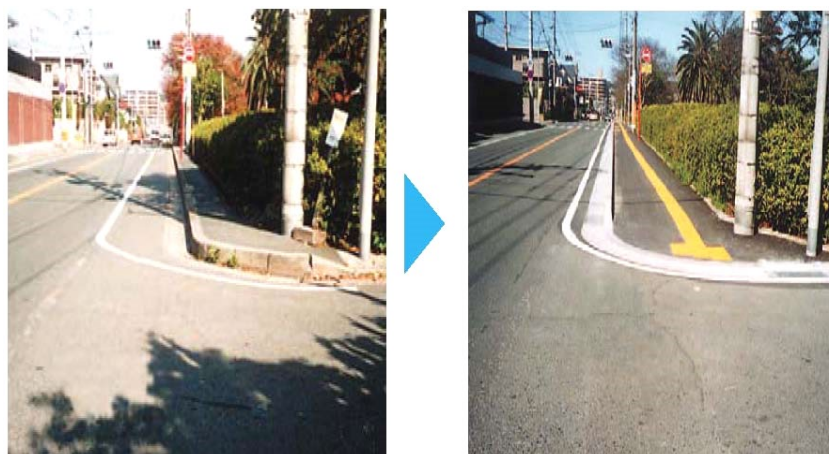
■歩道のバリアフリー化（マウントアップの改善、誘導ブロック設置）
