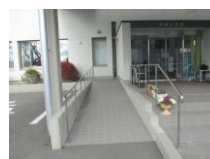
出入口の段差解消 事業費:30万円程度
