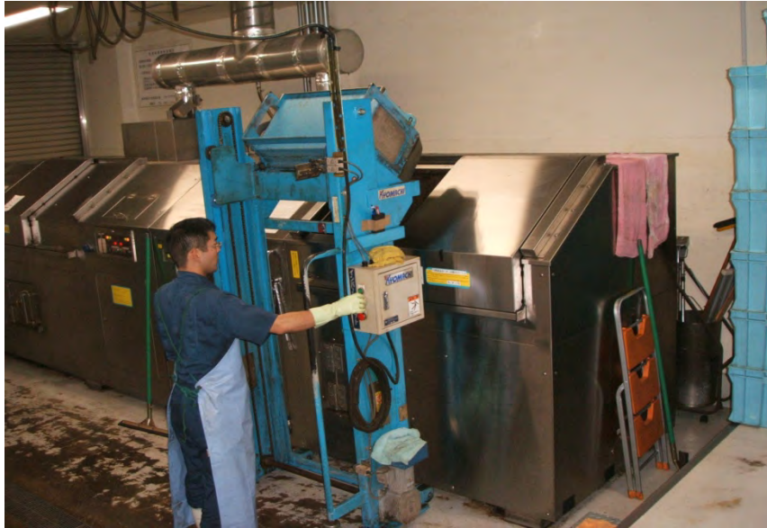
③ 処理機器バイオランナーへ『生ごみ』の投入
