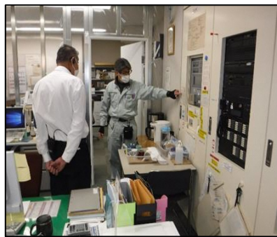
【分電盤の説明】
