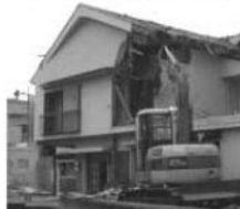
解体される被災家屋
