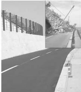
地震による土砂崩れの被害を受けた志賀島徳環線 (右上)。復旧工事を終えて全島的な通行が可能に ソリンスタン
