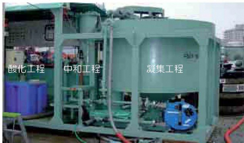
図 8-13 酸化、中和、凝集装置の概況写真
