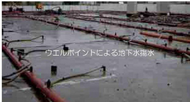
図 8-12 地下水揚水の概況写真
