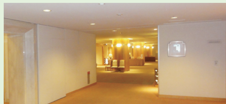
LED照明の使用
