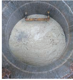
マンホールへ流出した油脂類の堆積で閉塞寸前の排水管
