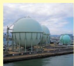
ガス貯蔵タンク
