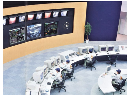
24時間体制の運転・監視の様子
