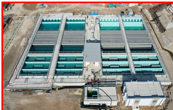
① 3系薬品沈でん池
