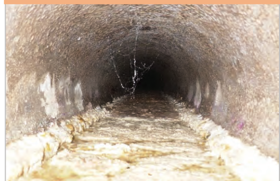
下水道管へ流出した油脂
